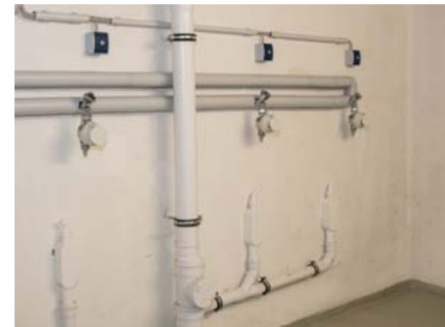
Wer seine Waschmaschine nicht im Badezimmer aufstellen möchte, der findet im Keller einen Waschmaschinenanschluss mit Wasserzähler und eine Steckdose, die über den Stromzähler seiner Wohnung abgerechnet wird.
